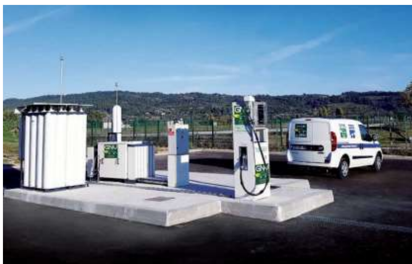
Figure 126 : Station GNV d'Apt (source : https://www.gaz-mobilite.fr/actus/premiere-station-gnv-intercommunale-vaucluse-2150.html )
